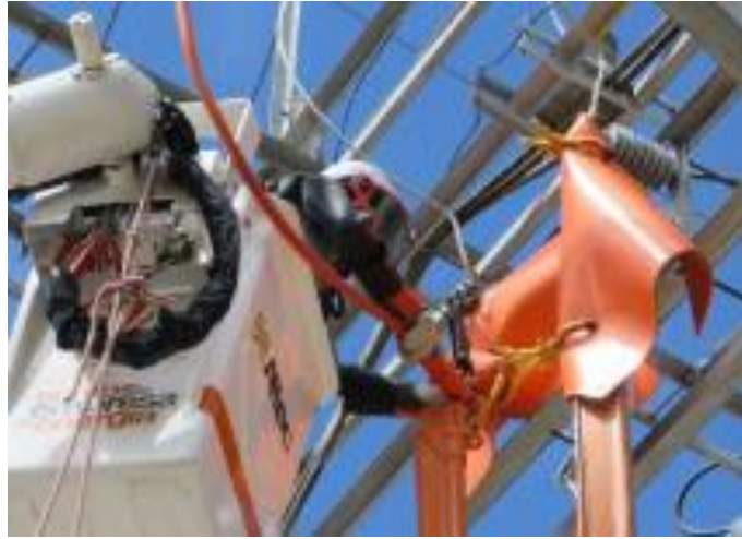
Imagen N°11. Instalación de jumper. Este es el décimo paso donde realizan la instalación del jumper para no interrumpir el funcionamiento del equipo. Fuente: Autor
