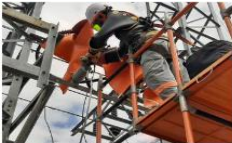
Imagen N°12. Labores y ajuste de conexiones en potencia. Este es el undécimo paso donde se realizan las actividades laborales y el ajuste de conexiones en potencia. Fuente: Autor
