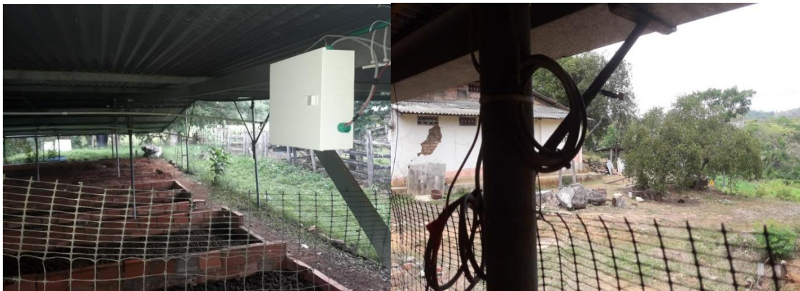
Figura 69. Instalación y resguardo de la caja de control del sistema
